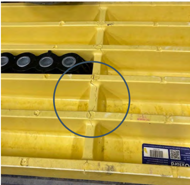
Riss entlang einer Querverstrebung
